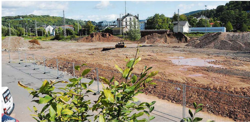
Die Baumaßnahme auf dem Gelände des geplanten Fachmarktzentums in der Rieffstraße gegenüber Kaufland geht nicht voran. FOTO: NORBERT WAGNER
